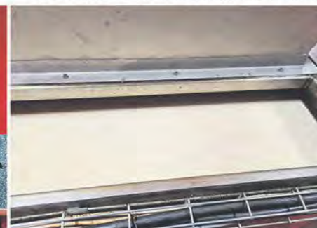
Ett av systemen kompletterades med en oljeavskiljare OAS2 med väldigt bra resultat.
