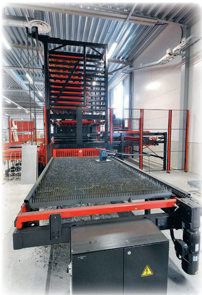
Maskinens plåthantering består av tre växelbord – Ett som är i skärläge i lasern, ett som är laddat med nästa plåt i tornet samt det tredje växelbordet, second out. Från det tredje växelbordet kan man välja att manuellt plundra de skurna detaljerna eller köra upp skeletten med detaljerna i materialtornet. Vid framtida behov kan man addera en detaljplock - TK-L på det tredje växelbordet
