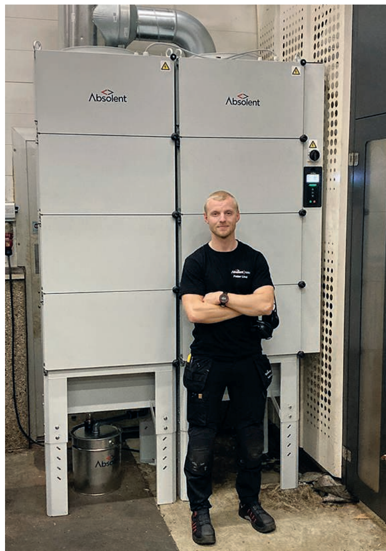
Här får vi träffa Petter Lind på bilden som är servicetekniker på Absolent. Han skall ha mycket beröm, då han har gjort rörinstallationerna hos ELME, plus flödesmätningar och partikelmätningar.
